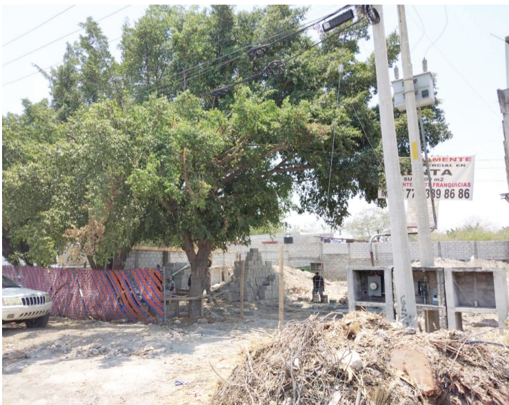
SE CLAUSURAN DOS construcciones en el municipio de Temixco, cerca del río Apatlaco, por la Procuraduría de Protección al Ambiente del Estado de Morelos por incumplimiento a la Ley Estatal del Equilibrio Ecológico y la Protección al Ambiente.
