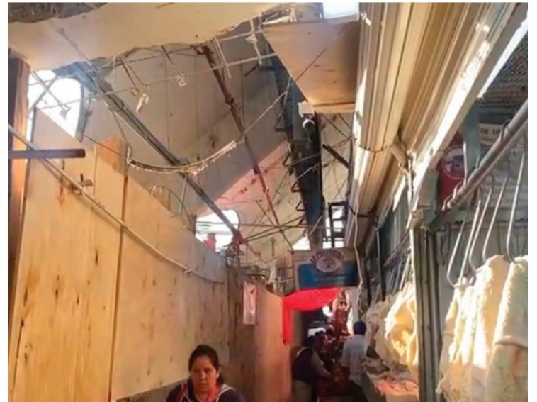
COMERCiantes DEL MERCADO Adolfo López Mateos de Cuernavaca denunciaron que los trabajos de remodelación de la nave principal se han detenido, por lo que hicieron un llamado a las autoridades para reanudar las labores.
